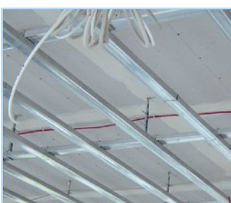
Metall Unterkonstruktion (Grobrost/Feinrost)
